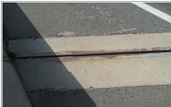
신축이음 상행선 A2 유간 이물질퇴적 및 녹발생
