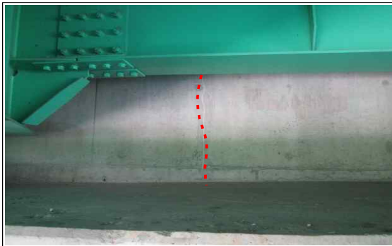
교대 하행선 A1 홍벽 균열(폭 0.2mm)
