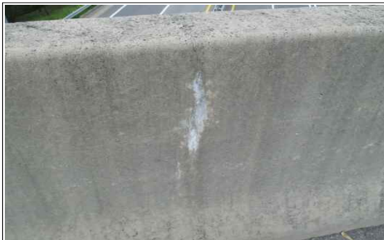
방호벽 고속도로방향 S1 균열부 백태
