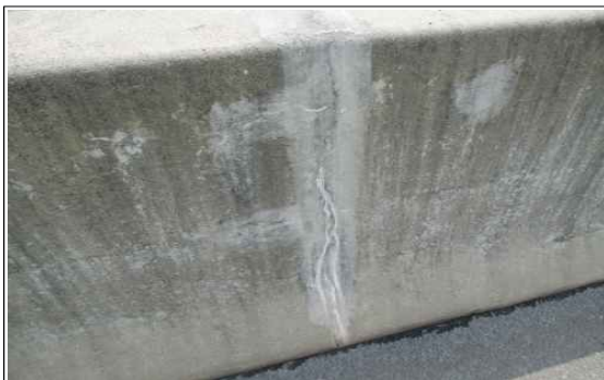
청도방향 S1 보수부 재균열(폭 0.2mm)
