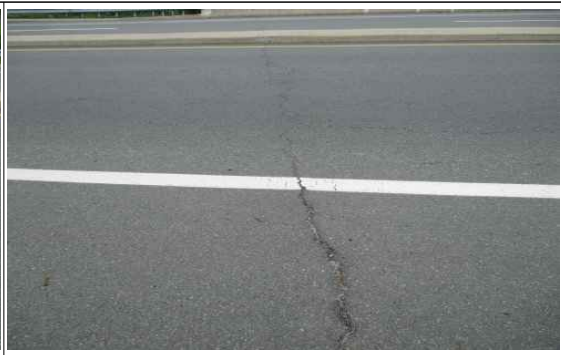
교면포장 고속도로방향 A2측 접속부 아스콘 균열
