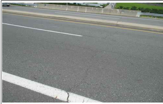
교면포장 고속도로방향 A1측 접속부 아스콘 균열
