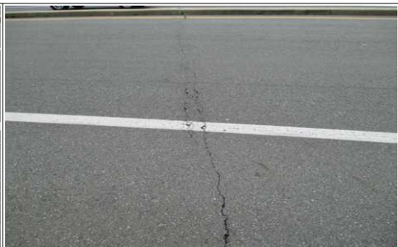
교면포장 국도방향 A2측 접속부 아스콘 균열
