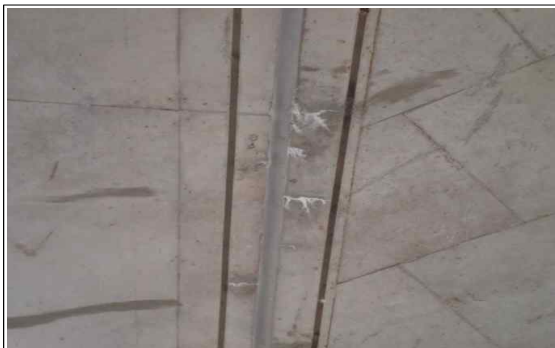
바닥판하면 청도·고속도로방향 S1 접합부 백태
