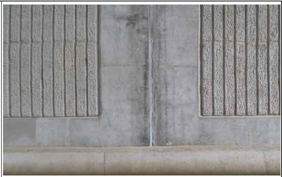
교대 국도·고속도로방향 A1 접합부 실란트 손상
