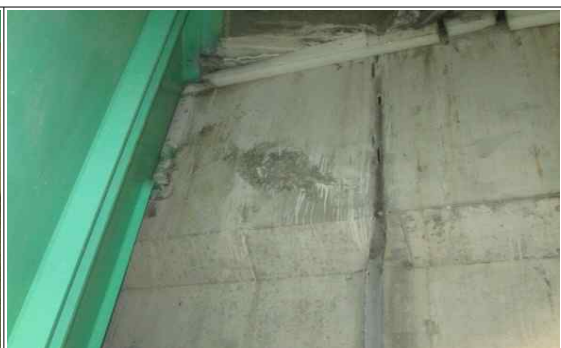
교대 상행선 A1 홍벽 보수부 백태
