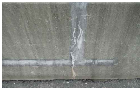
방호벽 고속도로방향 S1 균열부 백태(보수부 재손상)
