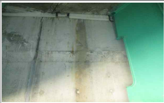
교대 하행선 A1 홍벽 누수흔적
