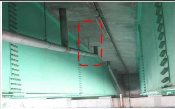
배수시설 하행선 S1 배수관 연결고리 탈락
