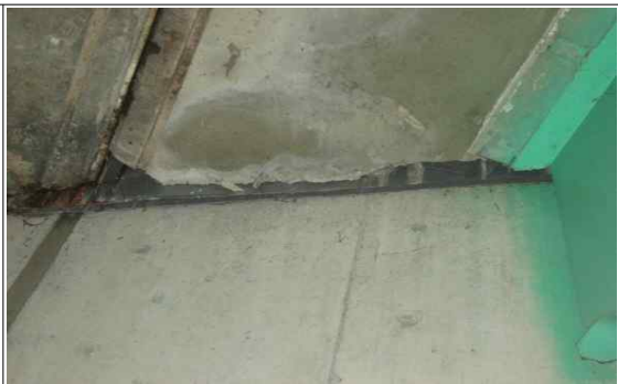
바닥판하면 상행선 S1(A2) 콘크리트 탈락
