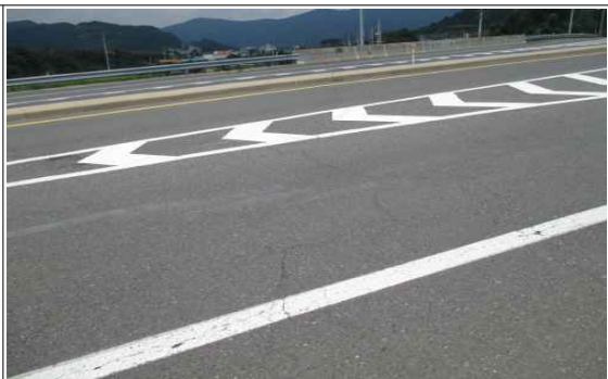
교면포장 청도방향 S1 접속부 아스콘 균열
