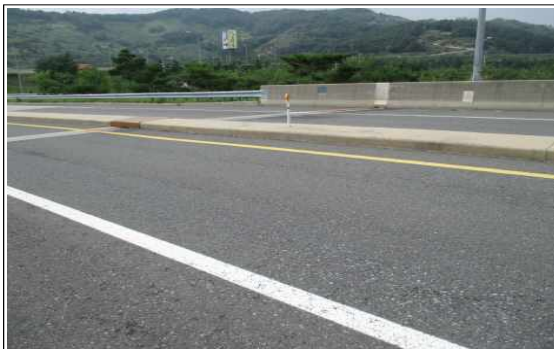
교면포장 청도방향 S1 아스콘 균열
