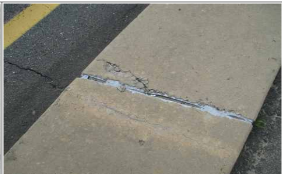
중분대 국도·고속도로방향 S1 콘크리트 손상
