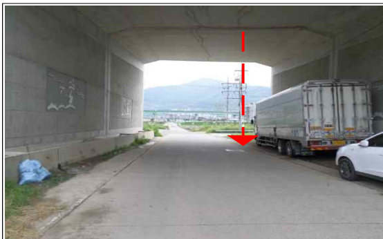
바닥판하면 국도·고속도로방향 S1 접합부 누수
