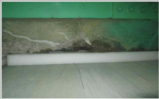
바닥판하면 상행선 S1(A1) 콘크리트 탈락 및 철근노출
