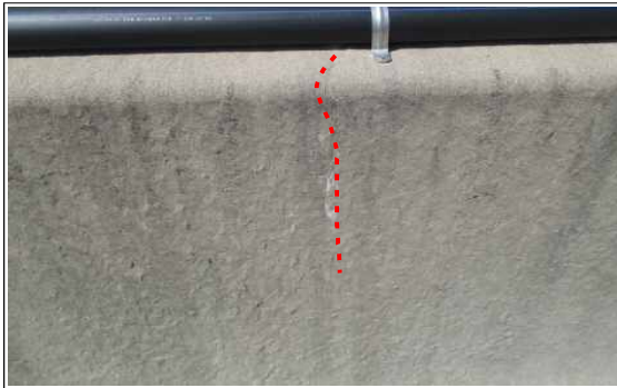
방호벽 하행선 S1 수직균열(폭 0.1mm)
