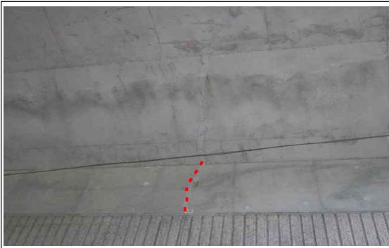
교대 국도방향 A2 보수부 재균열(폭 0.3mm)
