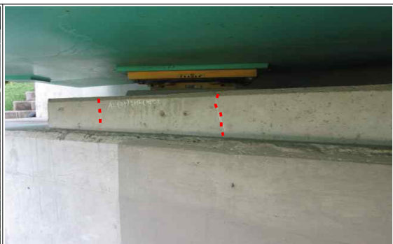
교량받침 하행선 A2 SH1 받침콘크리트 균열(폭 0.1mm)
