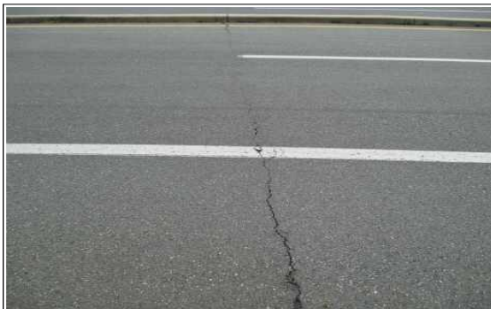
교면포장 국도방향 A1측 접속부 아스콘 균열
