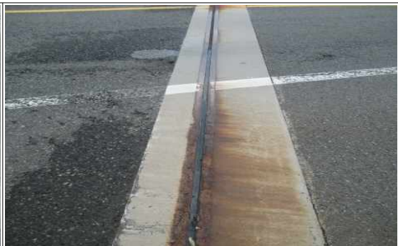
신축이음 고속도로방향 A1 본체 녹발생 및 이물질퇴적
