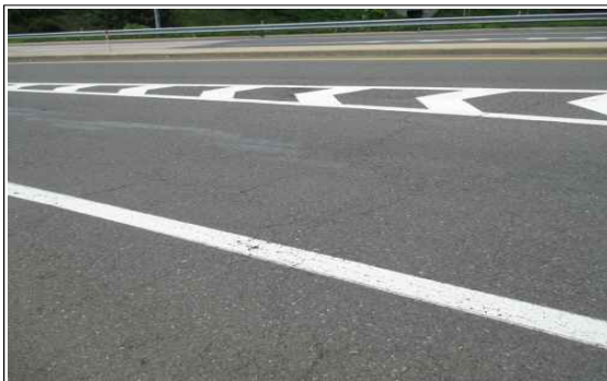
교면포장 청도방향 S1 아스콘 균열
