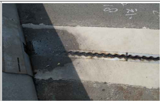
신축이음 상행선 A1 유간 이물질퇴적 및 체수
