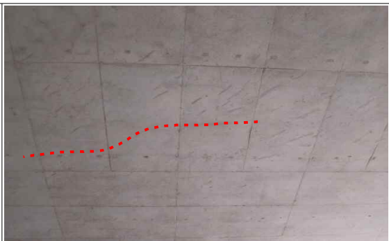
바닥판하면 고속도로방향 S1 균열(폭 0.3mm)
