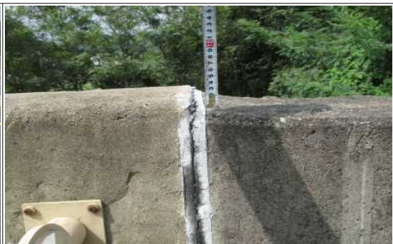
방호벽 고속도로방향 A2측 접속도로 단차 및 실란트 손상
