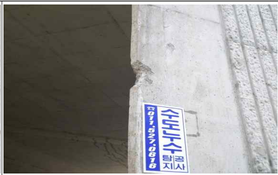
교대 고속도로방향 A2 콘크리트 손상
