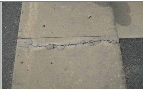
중분대 청도·고속도로방향 S1 콘크리트 박리
